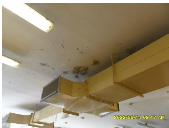
Foto č. 3 Ohniskový výskyt plísně na stropu v kuchyni
